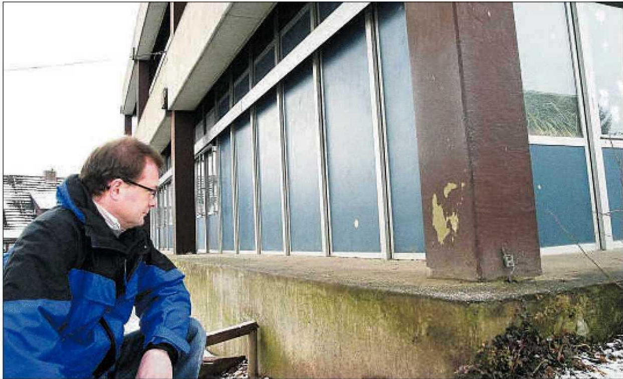
Charme der 70er-Jahre: Die Grundschule Simmershausen mit ihrer Betonkonstruktion und den Wandfächern aus Alu-Rahmen, alten Fenstern und dünnen Platten braucht laut Konrektor Andreas Wunsch eine Grundsanierung. Fotos: Schräer
