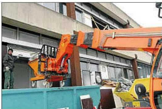
Abriss: Über eine Schleuse wird der Metallschrott per Container aus dem Erdgeschoss geholt.
