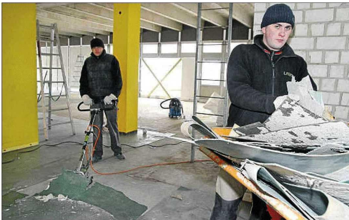
Bereits frei von Schadstoffen: Im Obergeschoss entfernen Lucas Wiechaczek (links) und Gregor Jarosch, Mitarbeiter einer Sanierungs-firma aus dem bayerischen Arnstorf, den verklebten PVC-Boden. Fotos: Schräer
